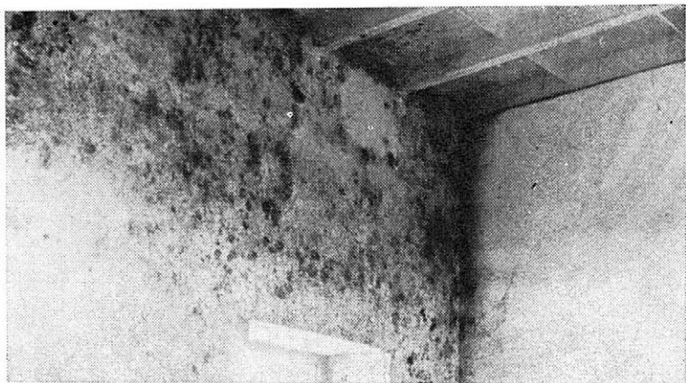
4. Zaplísňená venkovní stěna ve výkrmně typu „600“
